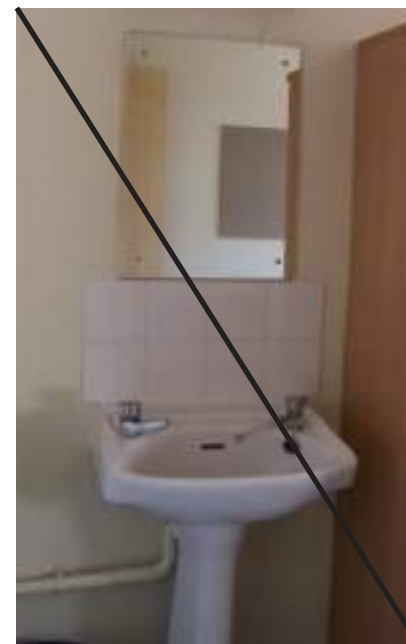
Плохо Раковина с пьедесталом. Фартук из плитки
